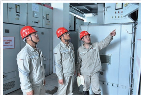
35千伏开关柜调试
